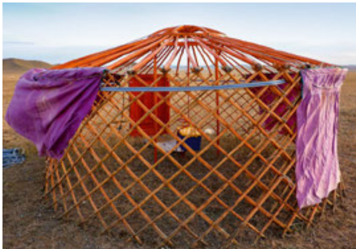
Hausbau. Am neuen Standort wird die Jurte mit geübten Händen aufgebaut. Als das Gerüst steht, geht der Rest schnell.
